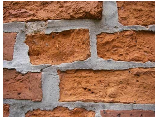
Durch den Mörtel wird die Steinoberfläche geschädigt
